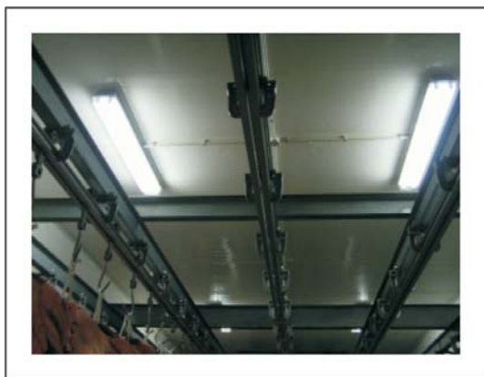
Imaxe de dúas pantallas de tubos fluorescentes con cebadores electromecánicos.
