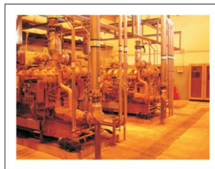
Imaxe da sala de motores dunha central de coxeración con dous motores a gas natural.
