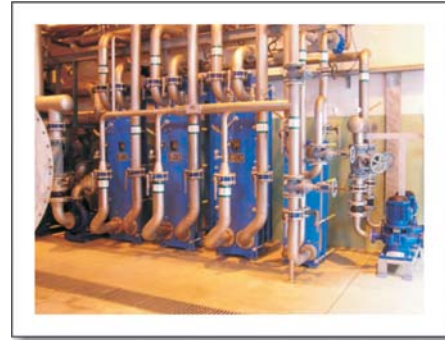
Imaxe de tres intercambiadores de placas.
