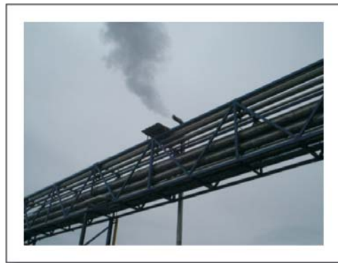
Aireación depósito de alimentación a caldeira da industria do exemplo seguinte
