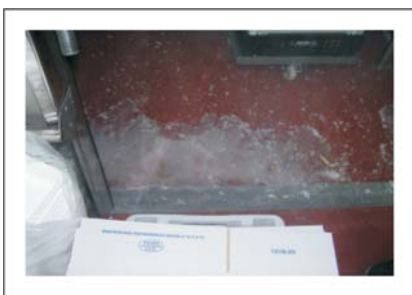
Imaxe de acumulación de xeo no chan dunha cámara de conxelación
