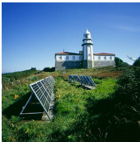
Instalación de energía solar en la isla de Ons
