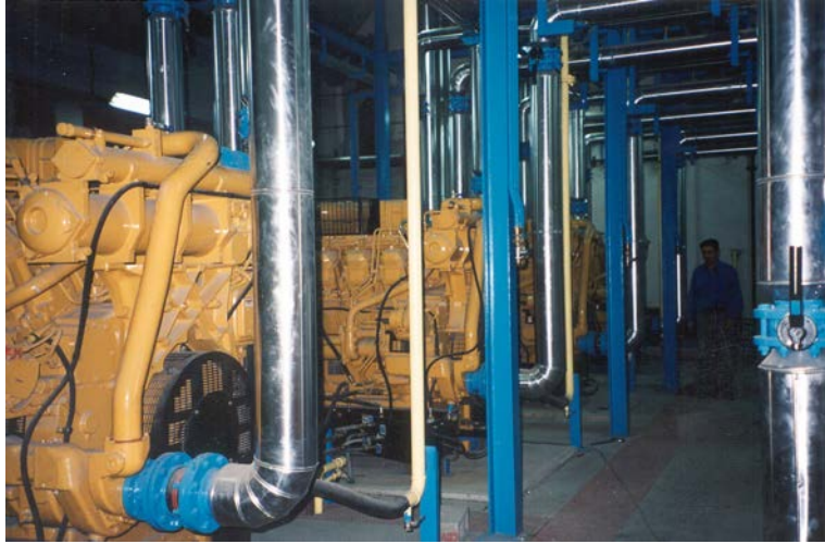
Sala de motores de una planta de cogeneración
