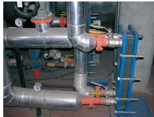
Sistemas de tubos e intercambiador de calor nun sistema de AQS
