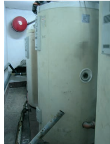
Depósitos acumuladores de AQS
