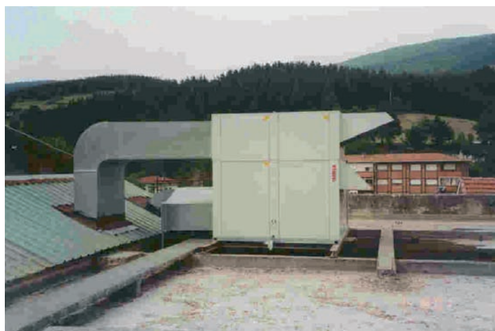
Arrefriadora con sistema free-cooling
