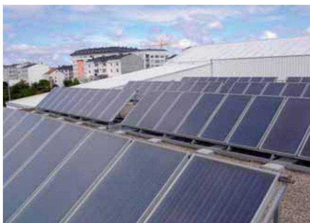
Instalación solar térmica nunha piscina climatizada na provincia da Coruña
