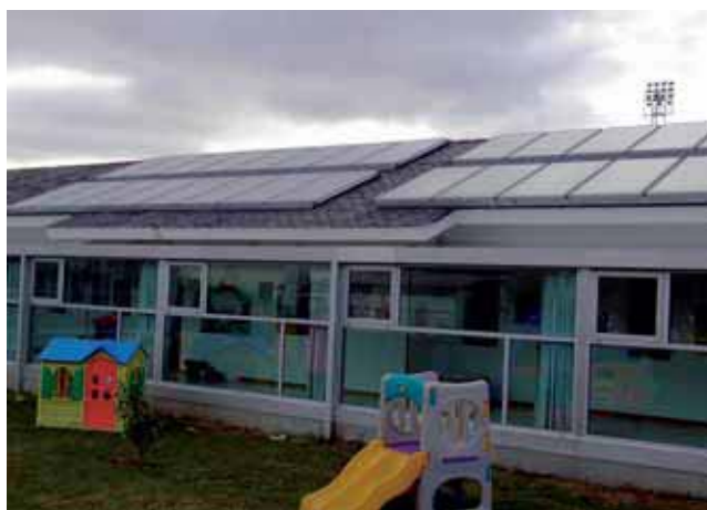
Instalación solar térmica nunha gardaría na provincia da Coruña
