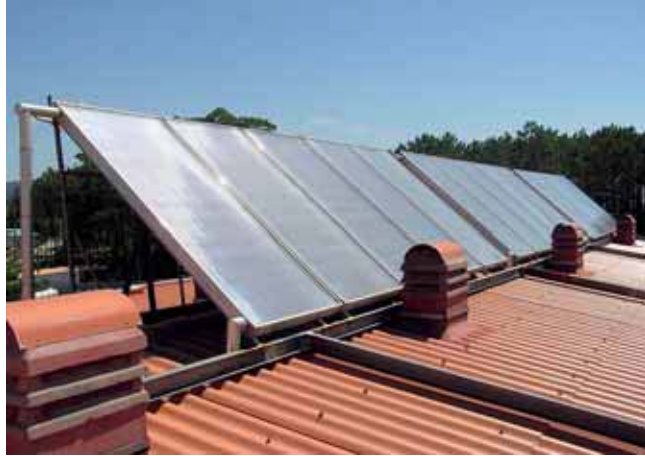
Instalación solar térmica na provincia de Pontevedra.
